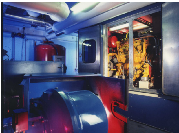
Blockheizkraftwerk (BHKW) in der Schönhauser Allee 10-11– das BHKW erzeugt Strom mit einem Gasmotor und nutzt gleichzeitig die Abwärme für die Heizung mit einem Wirkungsgrad > 90 % !
