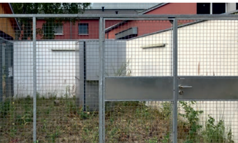
– Wärmepumpe in Hobrechtsfelde
