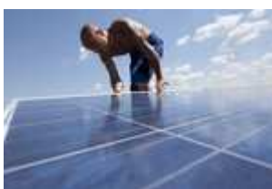
Solaranlage auf dem Dach der Wohnungsgenossenschaft "Bremer Höhe" im Berliner Stadtteil Prenzlauer Berg.
