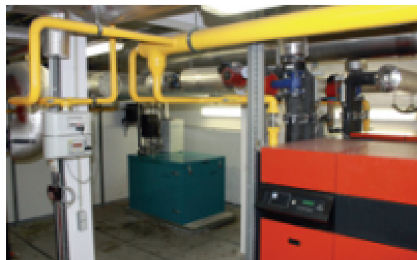
Hocheffiziente Blockheizkraftwerke wie dieses in der Dachzentrale Pappelallee 69 versorgen Haushalte im Lichtenberger Bestand und in der Bremer Höhe mit Wärme und Strom.
