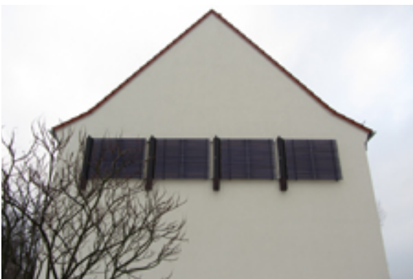
Die Photothermie-Anlage am Haus Dorfstraße 1-2.
