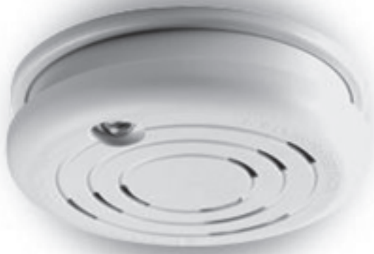
Rauchmelder an der Zimmerdecke
